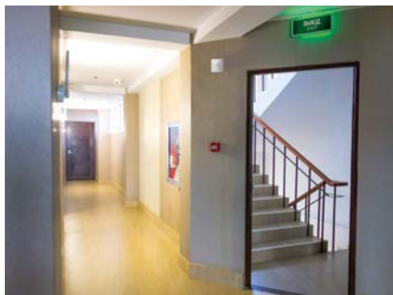
Лестница: аварийные светильники ДПА, датчики движения
