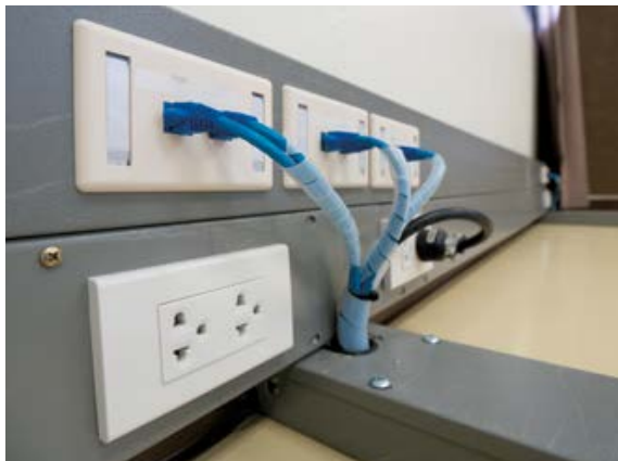
Информационные розетки с установкой в кабель-канал
