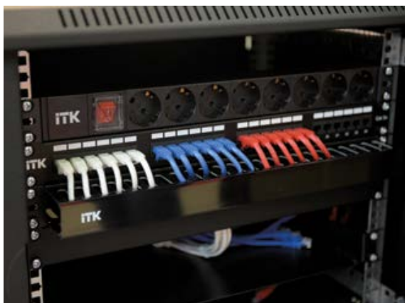
Настенный телекоммуникационный шкаф с оборудованием
