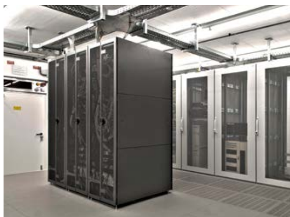
Серверные и уличные шкафы с системой мониторинга
