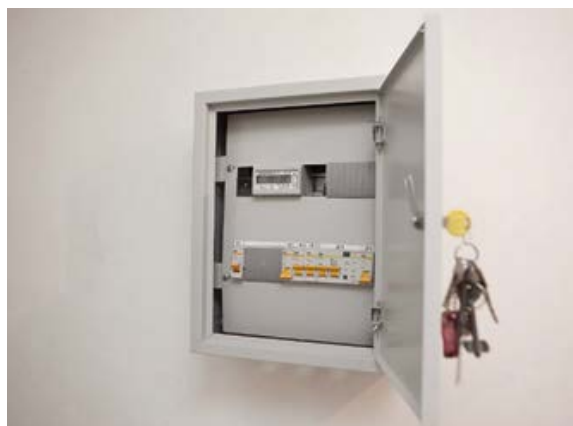
Модульные распределительные корпуса
